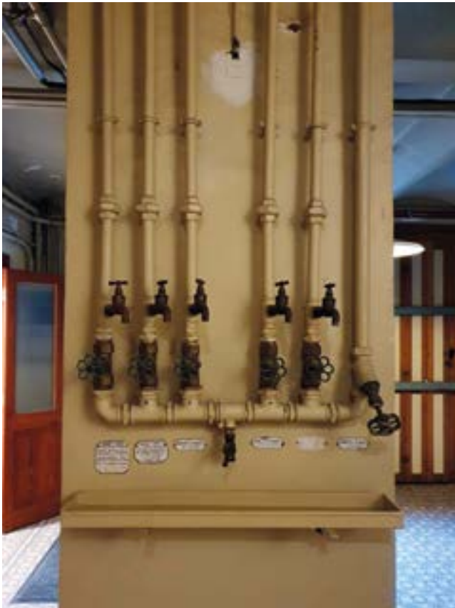
Waterleidingen in Hotel Solvay in Brussel, gebouwd in 1894–1898 (foto door F. Vandeputte).
