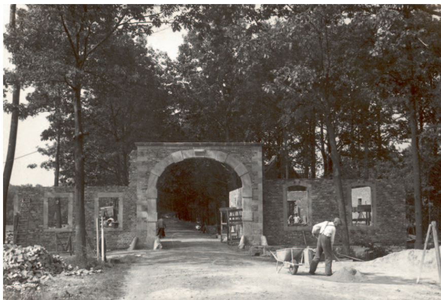
De opbouw van het Poortgebouw uit Heers in 1957, de grote toegangspoort tot het museum.
