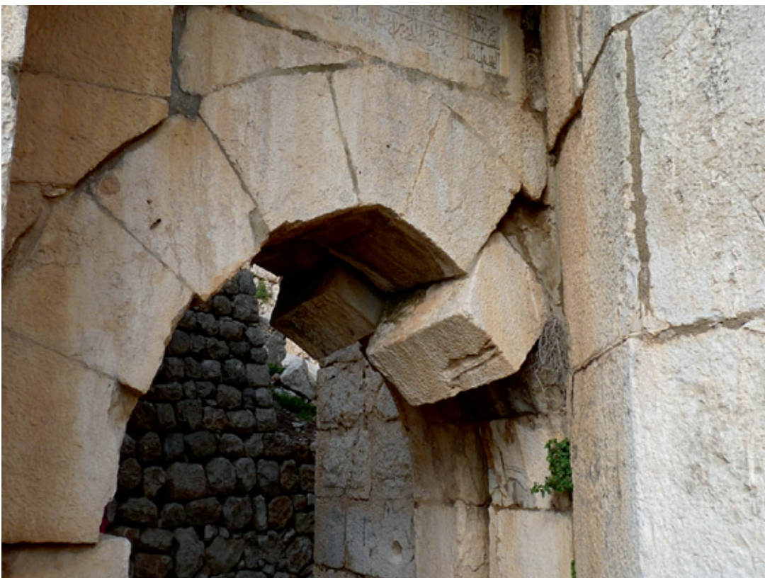
Figuur 5. Een typisch voorbeeld van aardbevingschade (verzakte sluitstenen in boogconstructie) in het middeleeuws Nimrodkaasteel op de Golanhoogvlakte. Mogelijk is deze schade in relatie te brengen met een historische aardbeving in de regio in de achttiende eeuw. Foto Sintubin, 2009.
