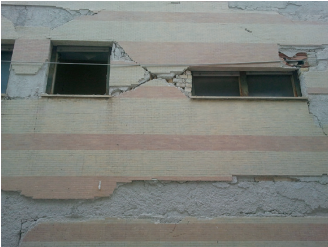
Figuur 2. Aardbevingschade aan een appartementsgebouw in de Italiaanse stad L'Aquila, getroffen op 6 april 2009 door een moordende aardbeving met een lokale magnitude van 5.9. De diagonale scheuren in de muur tussen de raamopeningen is typische aardbevingschade. De schade aan dit gebouw komt overeen met een intensiteit van VIII (EMS-98). Foto Sintubin, 2015.
